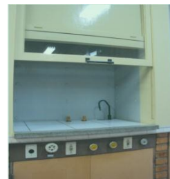
Capela de exaustão
